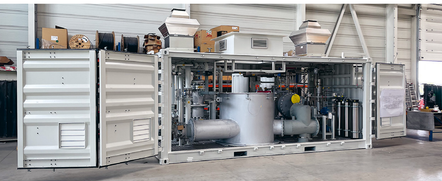
Anlage zur Dampfreformierung von Erdgas aus dem Vorprojekt HydroGIn zur Umrüstung auf Biogasbetrieb im Projekt BioHydroGen.
