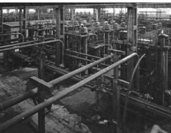
Kondensationsanlagen Druckgaswerk Schwarze Pumpe
