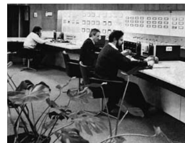
Zentrale Netzbefehlsstelle (ZBS) in Böhlitz-Ehrenberg.
