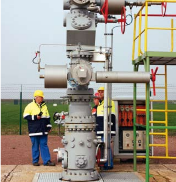
Inspektion eines Sondenkopfes. Hoch qualifizierte Mitarbeiter und zertifizierte Dienstleistungspartner sind Garanten für die Zuverlässigkeit des Gasspeichers.
