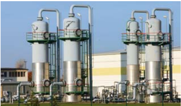
Absorber der Gastrocknungsanlage. Das hier eingesetzte Trocknungsmittel Glykol wird im Regenerationskreislaufsystem betrieben und bleibt dadurch mehrere Jahre im Einsatz.
