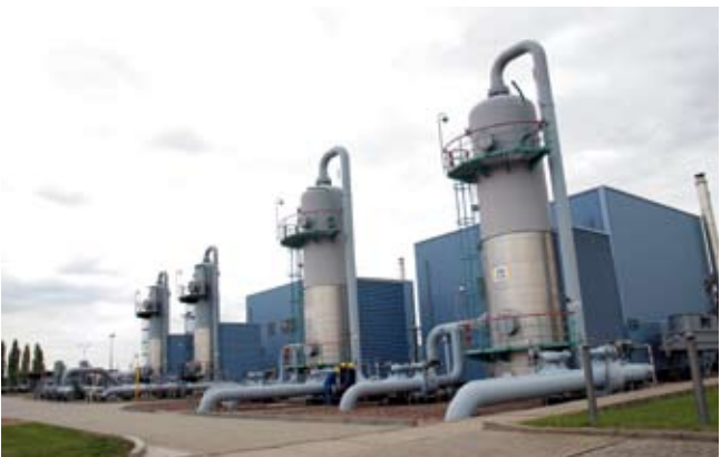
Absorber der Gastrocknungsanlage. Das hier eingesetzte Trocknungsmittel Triethylenglykol wird im Regenerationskreislaufsystem betrieben und bleibt dadurch mehrere Jahre im Einsatz.
