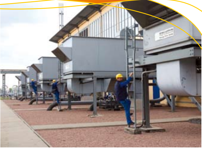
Außenfront der Verdichterhalle mit Zentrallüftungsgeräten.
