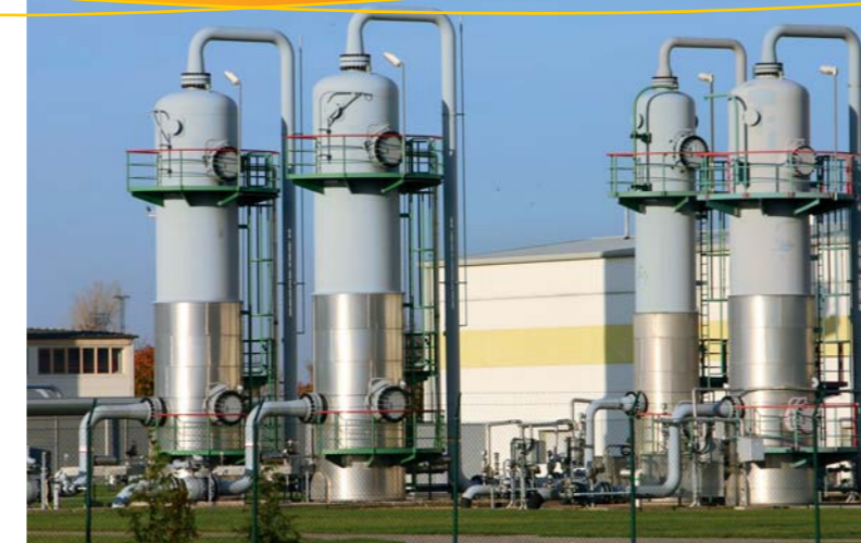
Gasreinigungsanlage auf dem Untergrundgasspeicher Bad Lauchstädt
