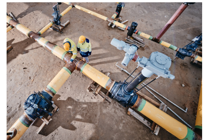
Effiziente Gasverteilung: Modernste Technik und Fachwissen sorgen für eine nachhaltige und leistungsfähige Infrastruktur.
