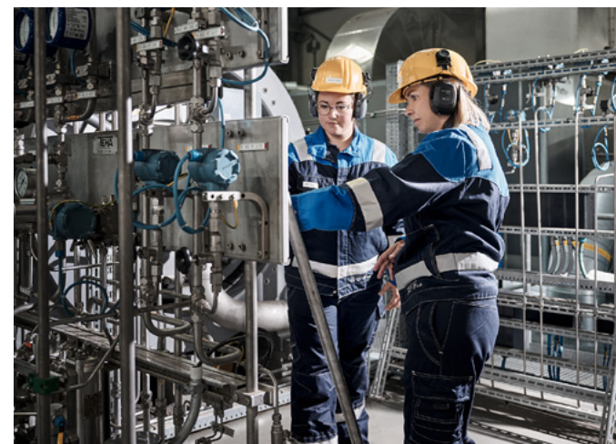
Sichere Gasinfrastruktur: ONTRAS-Mitarbeiter überwachen und warten Anlagen für eine zuverlässige Energieversorgung.
